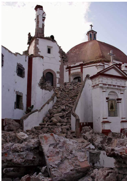
Imagen 5. Daños en la torre campanario y escalinatas (fuente: Cortesía de Eder Torres Villamar del Consejo Parroquial, 19 de septiembre de 2017).
